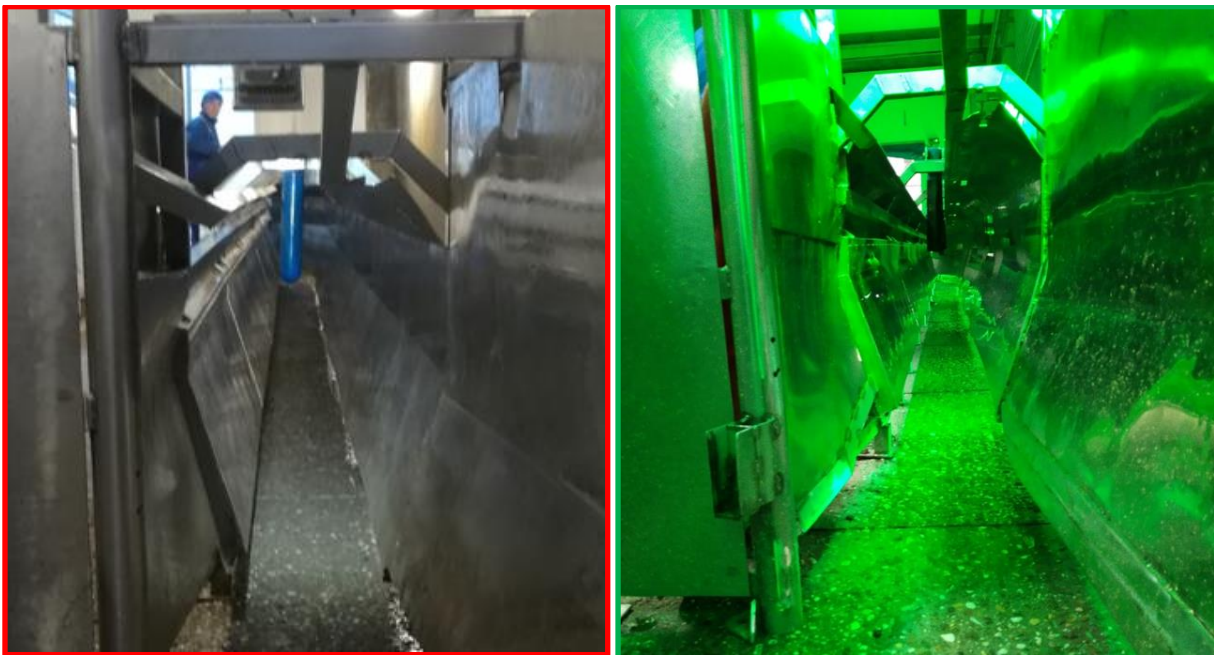
Links: oude situatie waarbij de zijkanten van de drijfgang nog open zijn en medewerkers zichtbaar. Rechts: nieuwe situatie waarbij de zijwanden zijn dichtgemaakt. Medewerkers zijn niet meer zichtbaar, maar door de nieuwe belichting zijn wel meer schitteringen ontstaan.
